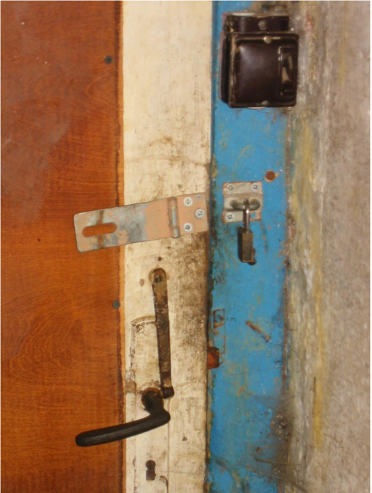
Indgangsdøren som er simpel med hængelås Foto James Arbøl
